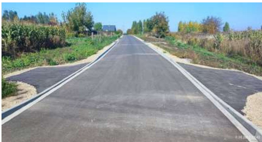
Fot. 5 Droga gminna ul. Bema do ul. Św. Jana Pawła II w Słomnikach
